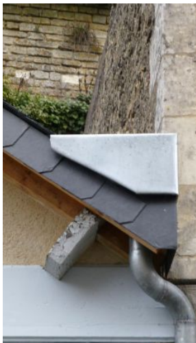
Un chéneau mal fait sans trou de décharge
